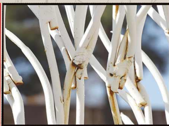
رنگ زدگی به دلیل عدم استفاده از مخزن رنگ (رنگ کاری پیستوله ای)
